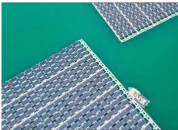
Centrale photovoltaïque flottante O'MEGA1 à Piolenc
