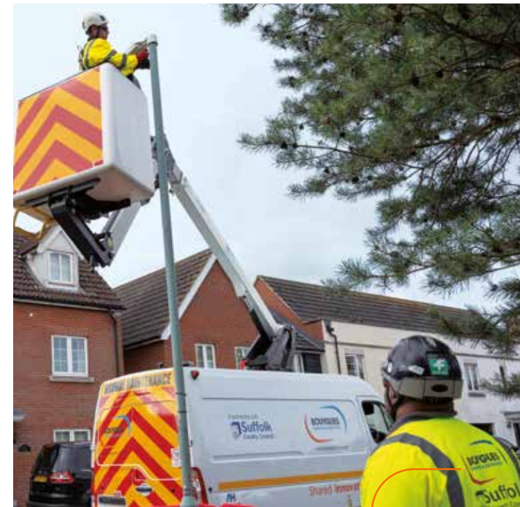
Die neue Straßenbeleuchtung in der Grafschaft Suffolk in England senkt die Kosten um mindestens 60 %, spart Energie ein und verringert die Lichtverschmutzung
